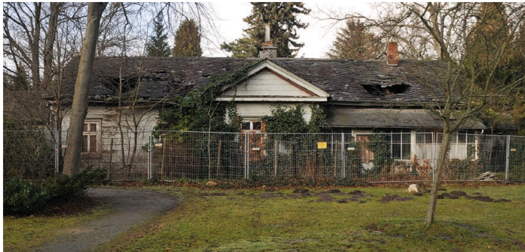
Leichenhaus und Wohnhaus des Totengräbers, späteres Verwaltungsgebäude, im Januar 2012 kurz vor dem Abbruch. Das Dach ist teilweise eingebrochen.
