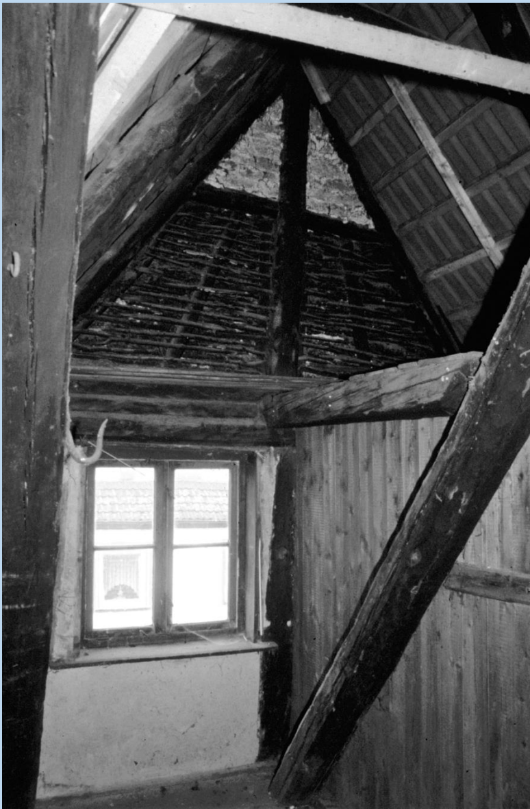
Einbeck, Baustraße 18, Zwerchhaus mit zuge-setzten Rauchlöchern, Aufnahme Kellmann 2002.
